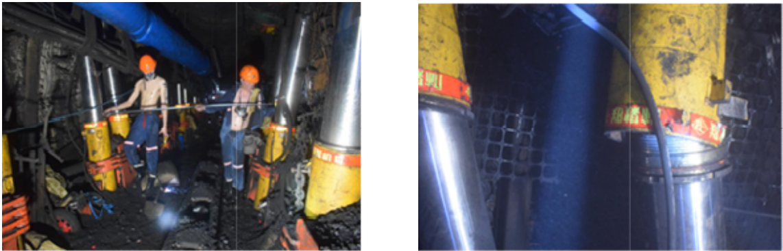
图 8 上平巷超前 10~100m 段巷道破坏及单元式支架损坏图
