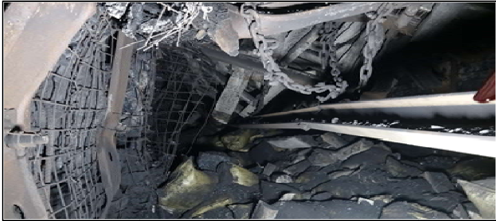
图 9 三联巷上口 24m 至 40m 段巷道破坏情况图
